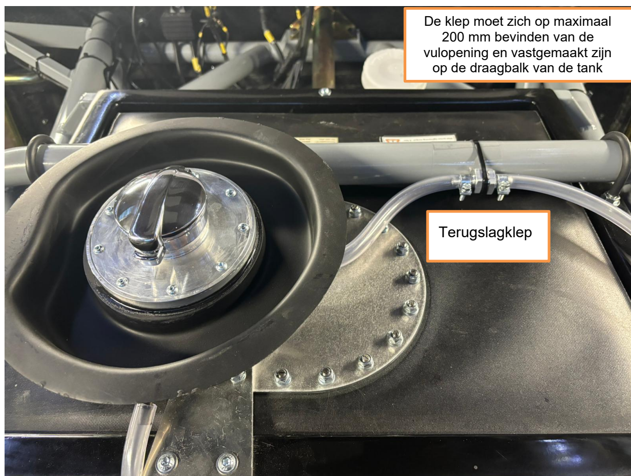
Foto 1: installatie terugslagklep met ATL PP-20F-klep
